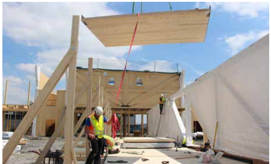
Bild 12: Die 12 cm dicken BSP-Platten der Shed-Gräben sind als Deckenscheiben ausgebildet und mit den Untergurten der Haupt-Fachwerkträger verschraubt, um sie gegen seitliches Ausknicken infolge von Druckkräften zu fixieren. Im Hintergrund: Die wandartigen Träger an den Stirnseiten der Hallenschiffe. (Foto: SWG Schraubenwerk Gaisbach GmbH – Geschäftsbereich Produktion)
