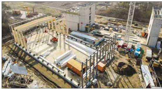
Baustellen-Luftbild vom März 2019: Im Hintergrund sind die beiden schmalen Stahlbeton-Erschließungstürme zu sehen. Der am linken Turm anschließende Massivbau ist die Technik-Zentrale. Sie ist durch eine Gebäudefuge statisch und brandschutztechnisch autonom.
