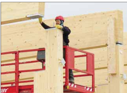
Eine Stahlplatte mit Loch auf der Binderunterseite und eine am Stützenkopf mit einem Stahlstift – samt Elastomerlager dazwischen – stellen den Anschluss am Auflagerpunkt Balken/Stütze her. Zwei seitliche Hölzer sichern sie während der Montage gegen Kippen.
