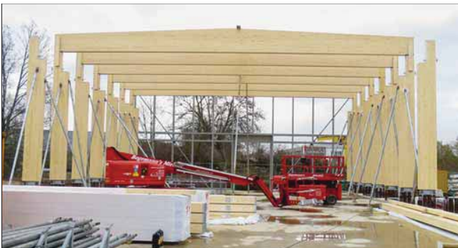
Satteldach-Binder auf B5-Holz-Stützen überspannen die knapp 20 m breite Halle im Abstand von 2,80 m. Mit der Satteldachform konnte die Dachentwässerung sichergestellt werden. Fotos (4): DGI Bauwerk Gesellschaft von Architekten mbH
